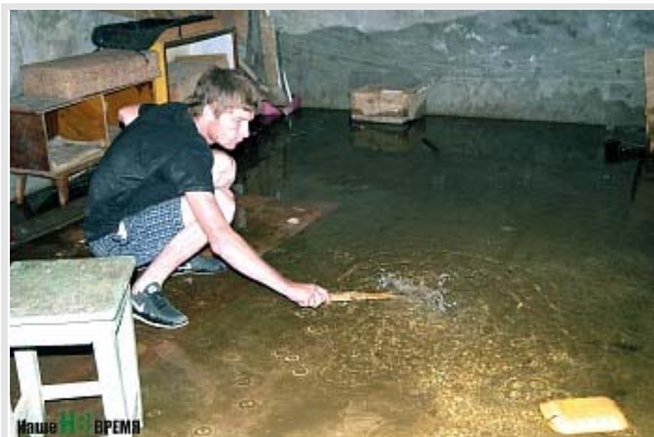
Озеро в подвале дома №8.
